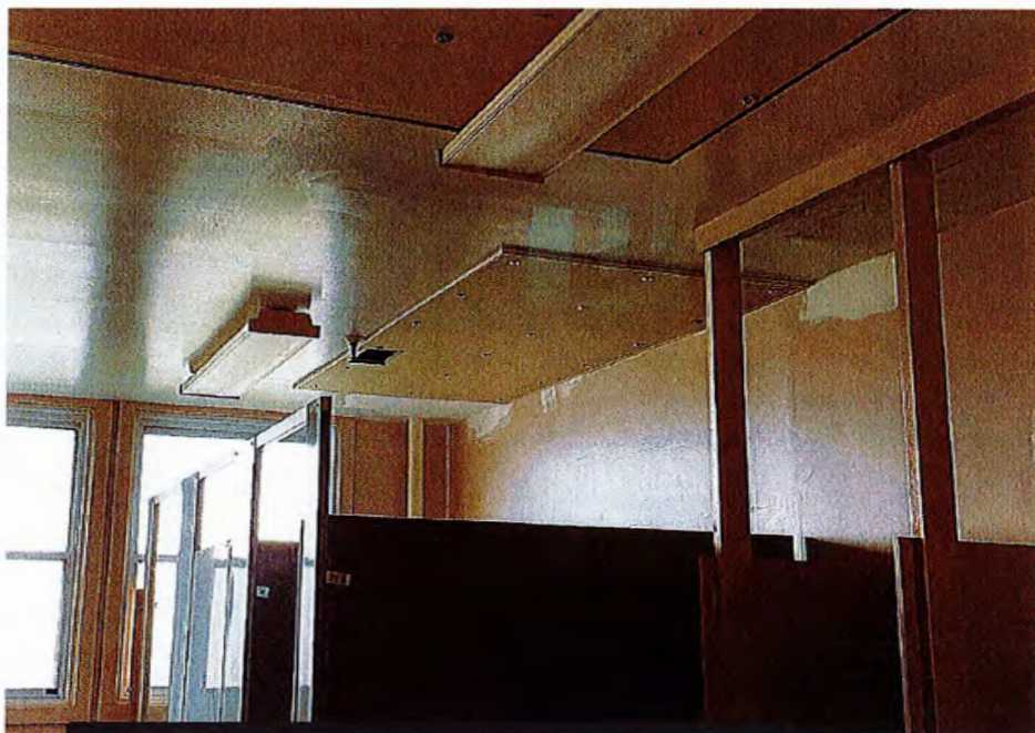
Les panneaux au-dessus des toilettes remplacent des morceaux enlevés à cause de la moisissure.
