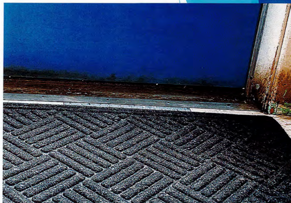
La neige entre à travers les trous. Voir aussi l'usure et la moisissure à droite.
