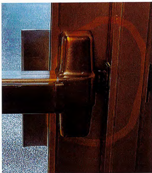
Porte du gymnase qui ne se ferme pas n'aise à la sécurité de l'école.
